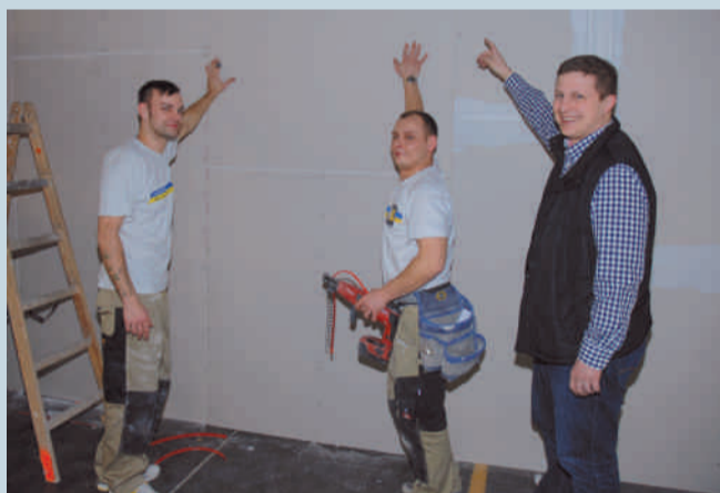
Den beiden HS-Trockenbauprofis aus Limbach-Oberfrohna, René Otto und Michael Homenko, braucht Ulrich Beck eigentlich nicht erklären, was „F90“ bedeutet – dem Fotografen zuliebe tut er es doch (v.li.).
